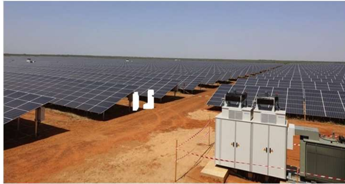
Fig. 1. Centrale solaire de Bokhol/Sénégal
